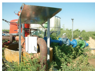
Figura 4.- Instalación intemperie de Remota GPRS
