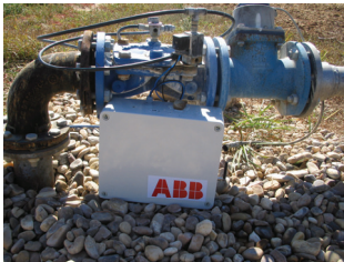
Figura 1.- Remota GPRS a pie de hidrante
