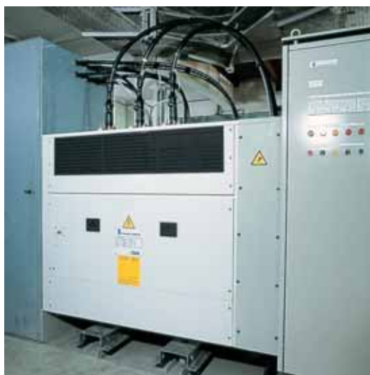
630 kVA - 20 kV/400 V
